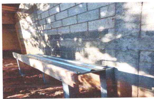
Foto6: Pila en mal estado
